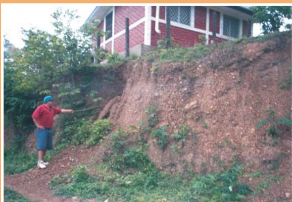
Ing. Valle señala la erosión hídrica que pone en riesgo la recién construida Casa del Maestro en la Escuela de La Providencia.
