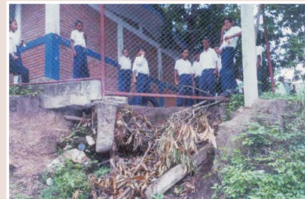
Bases socavadas del edificio del Instituto José de La Cruz Mena, Municipio de El Jícaro.
